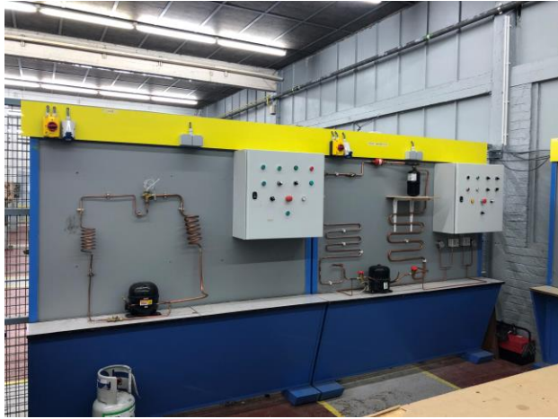
Montage circuit + commande électrique
