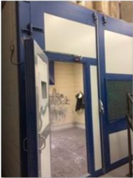
1. extérieur d'une cabine de métallisation
