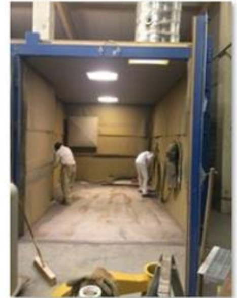
3. intérieur d'une cabine de sablage
