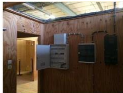
✔ Cablage intérieure de la maison
