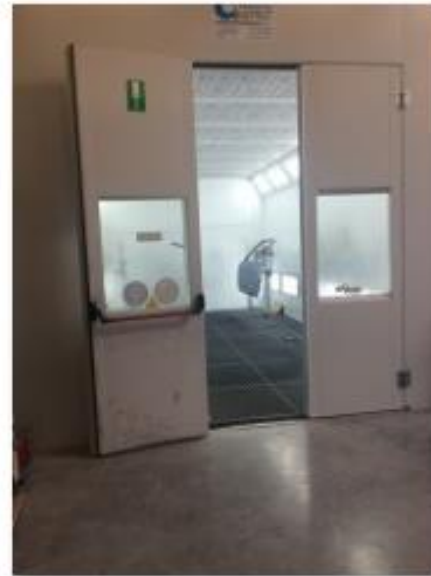
✔ Cabine de peinture avec zone de préparation et Labo mixing (2)
