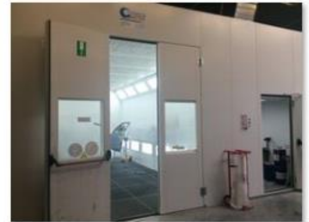
✔ Cabine de peinture avec zone de préparation et Labo mixing (3)
