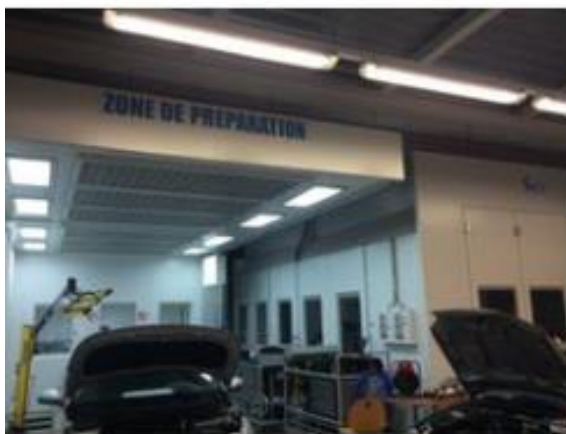
✔ cabine de peinture zone de préparation
