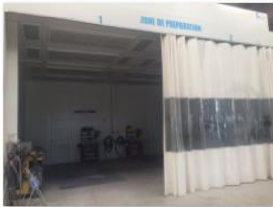
✔ Cabine de peinture avec zone de préparation et Labo mixing (1)
