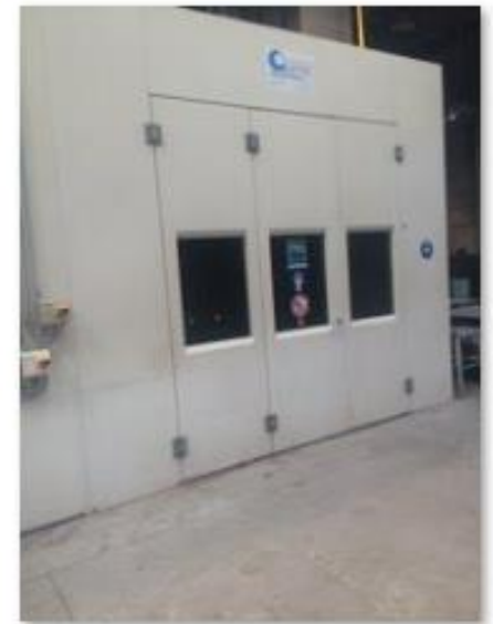
✔ Cabine de peinture avec zone de préparation et Labo mixing (3)
