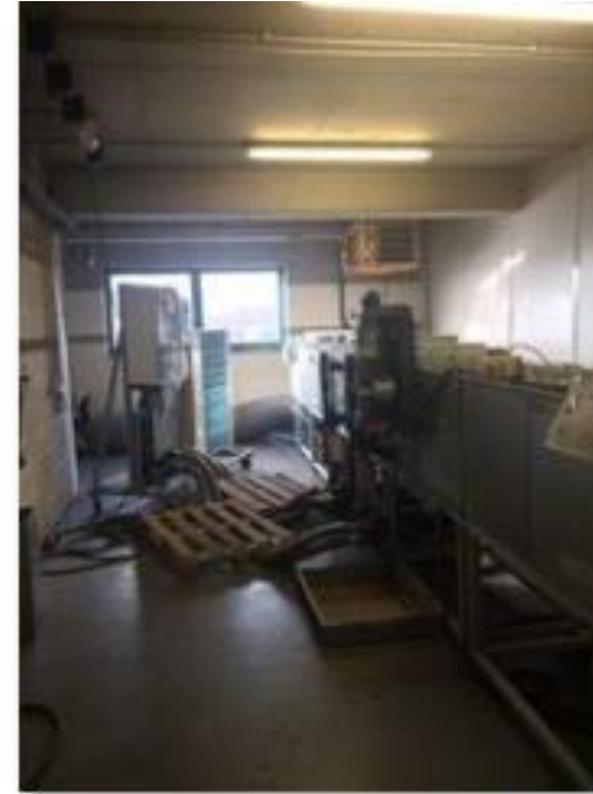
✔ centrale de traitement d'air ERM avec pompe a chaleur mitsubishi
