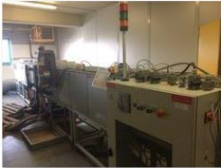
✔ centrale de traitement d'air druat commandée par automate schneider M340
