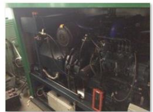
✔ moteur thermique électrique HVAC cogeneration
