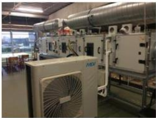
✔ unité HVAC Munters
