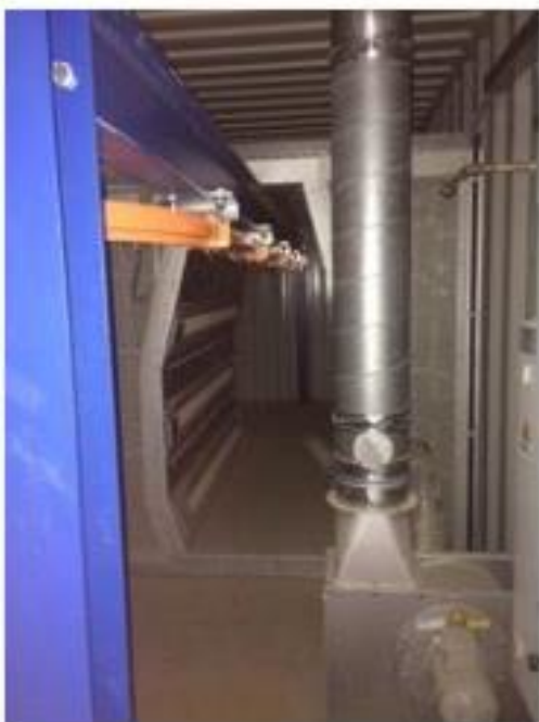
✔ 1. interieur d'une cabine mobile
