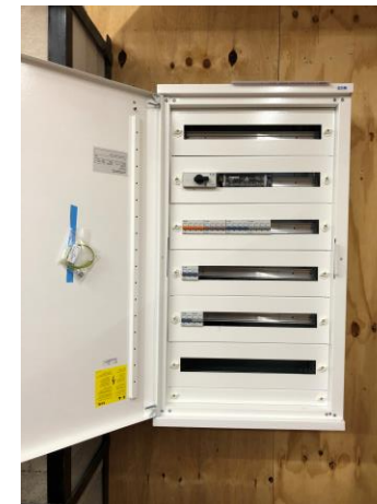
Petit TGBT (Tableau Général Basse Tension)
