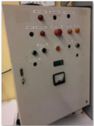
armoire électrique récente
