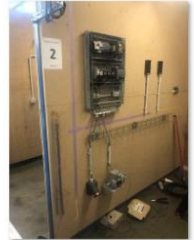
✓ coffret automate interieur
